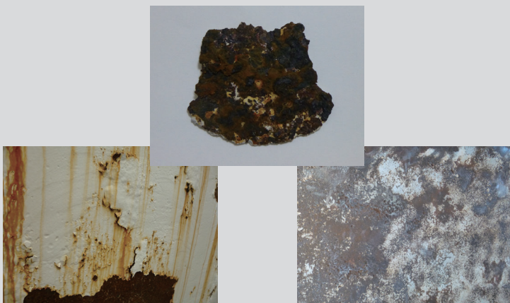
▲ (左・中) 剥離した塗膜。塗膜裏面は錆。(右) 鋼材面の小さな無数の穴からも、減肉したことが窺える。
