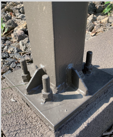
▲ 錆びやすい支柱の根元は重防食仕様。
