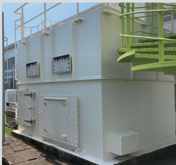
▲ 施工後。水性トップコート使用。3年経過後も良好な状態を保つ。
