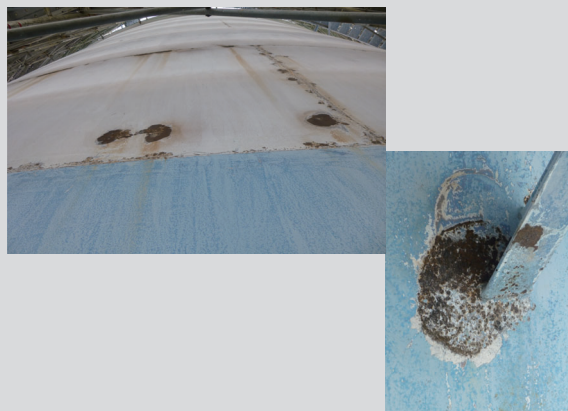
▲ 素地調整後。溶接部は特に電位差が生じやすく錆びやすい。
