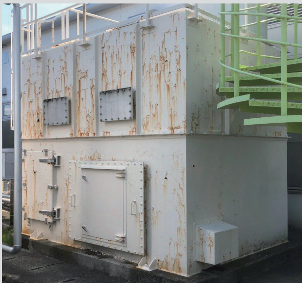
▲ 施工前。塗装の保護機能が失われ、塗膜下・鋼材面に水の浸入が繰り返される。
