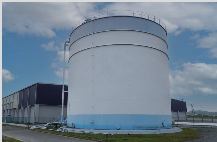
▲ 施工前。チョーキング・発錆。
