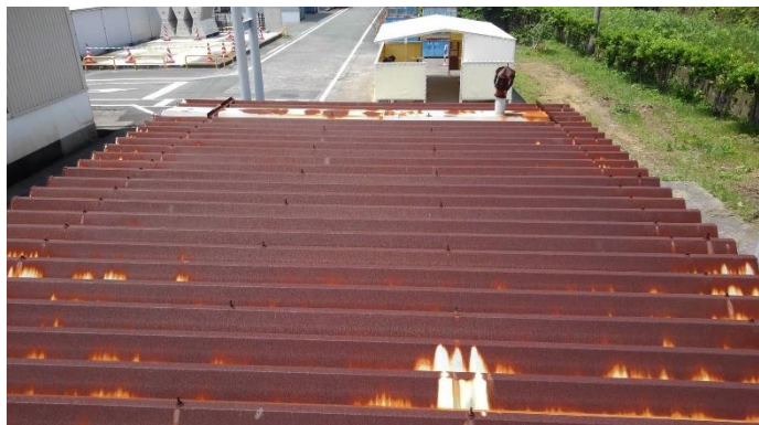
全体的に錆びている。ケレンと高圧洗浄で素地調整。
